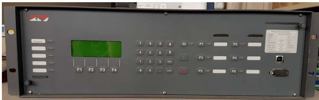
Figura 32. Protección de distancia ZLV Distance.
