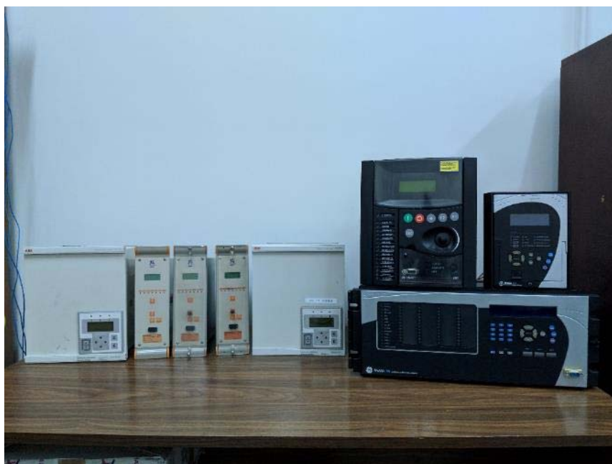
Figura 31. Equipos de protección y control
