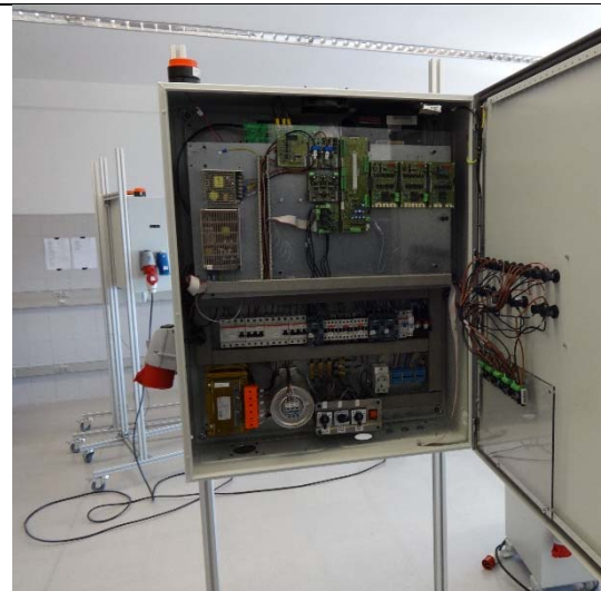
Interior del armario eléctrico de la etapa de inyección a red.
