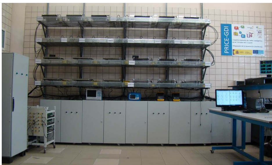
Figura 2: Red de distribución MT a escala de laboratorio.
