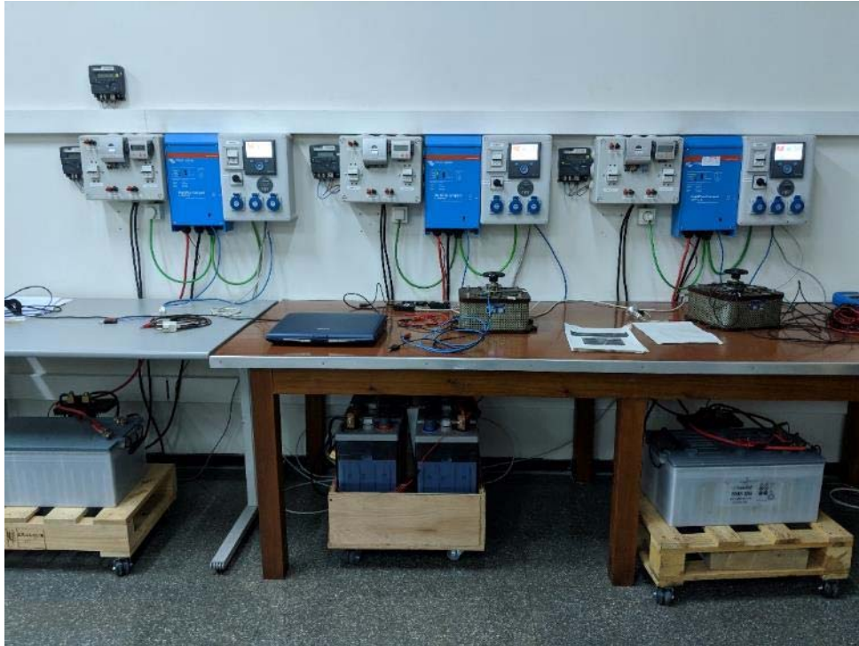
Figura 7. Vista general del laboratorio de fotovoltaica.
