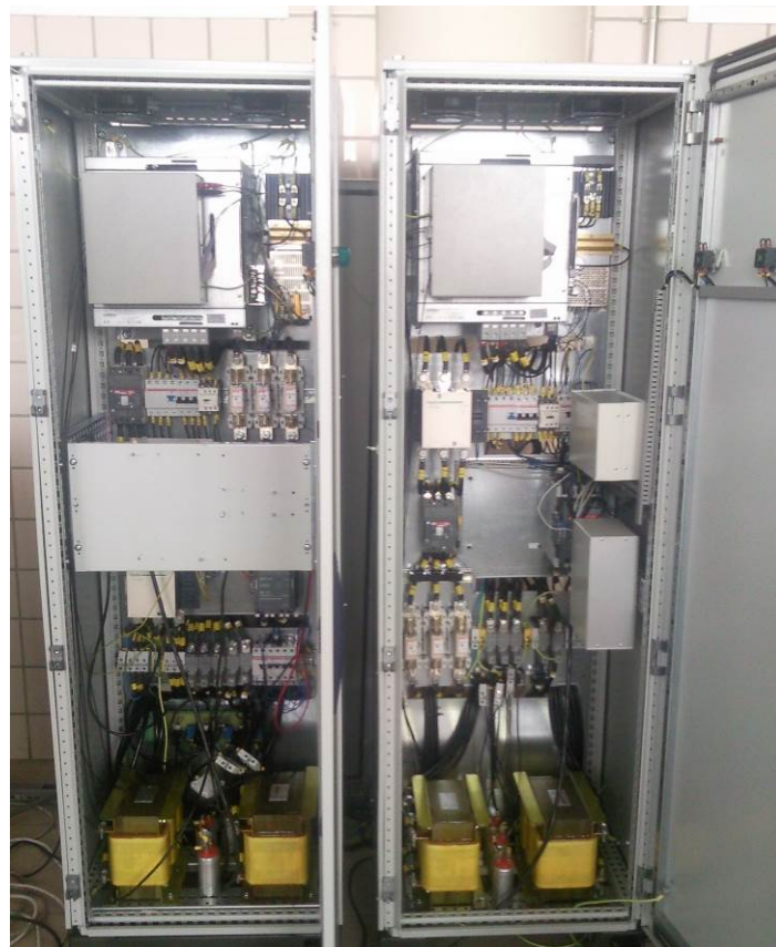
Figura 11. Enlace de continua con topología back-to-back para mallado flexible de la red de distribución (400 V y 100 kVA).
