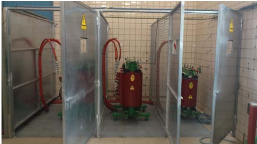
Figura 5: Vista del laboratorio de media tensión.
