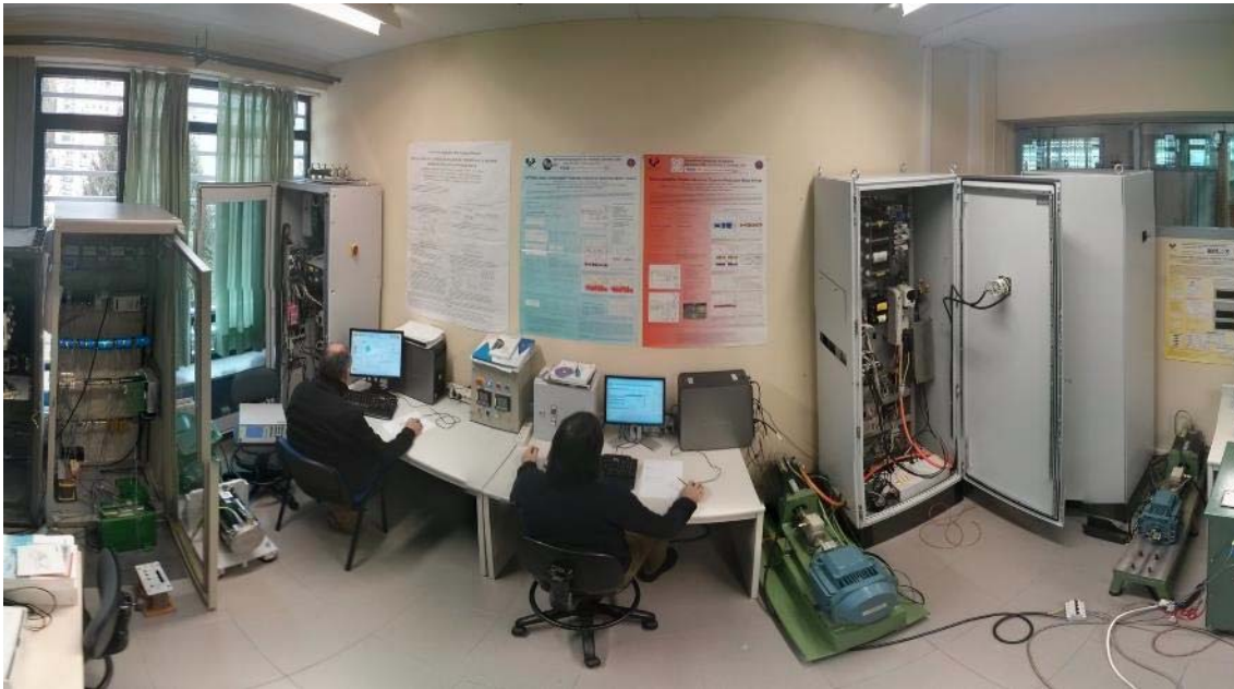
Figura 2. Vista general del laboratorio de electrónica de potencia.
