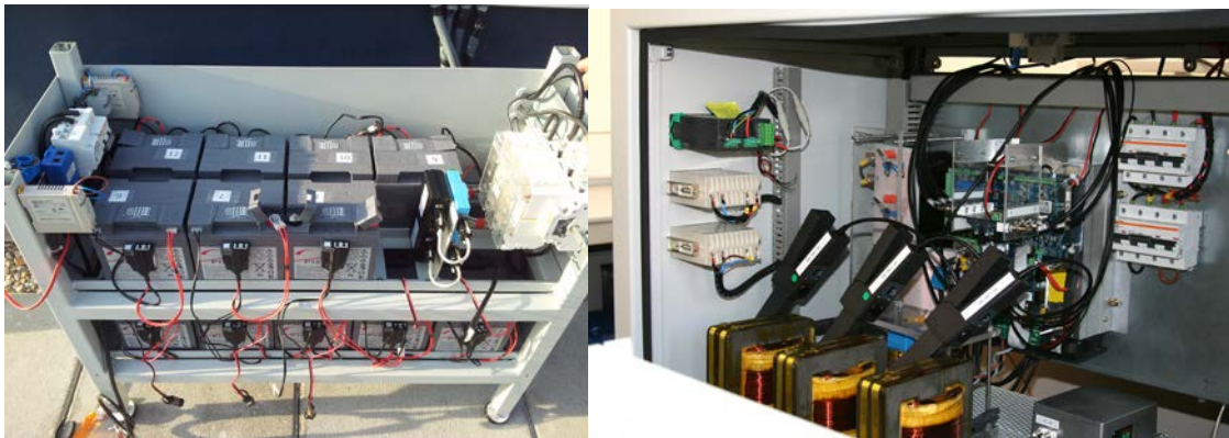
Banco de baterías y convertidor de conexión a bus DC 650V
