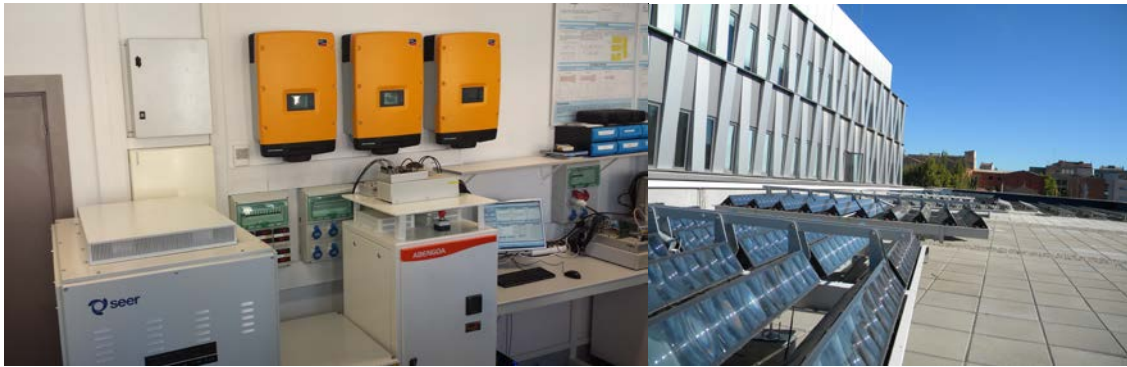
Etapa de conversión de planta fotovoltaica 20kW & Instalación experimental de paneles de concentración
