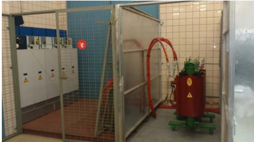
Figura 6. Vista del laboratorio de media tensión.
