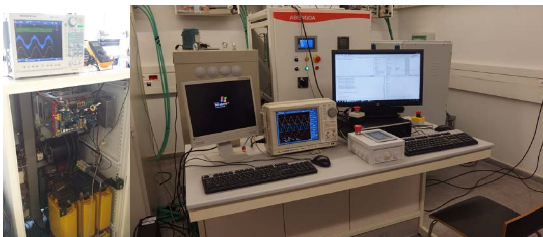
Convertidor de conexión a red 100kW en laboratorio de ensayo
