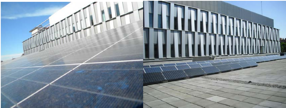
Planta fotovoltaica 20kW paneles policristalinos y monocristalinos
